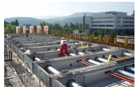
fertig montierte Haustechnik in den Trogelementen vor dem Einbau der Filigrandecken und Überbeton
